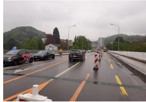
Ungenügende Veloführung bei Baustellen
