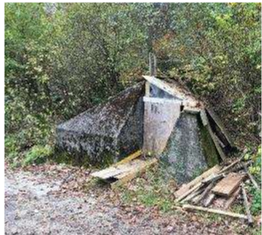
Umnutzung Panzersperre als Hütte - Bestand 2019
