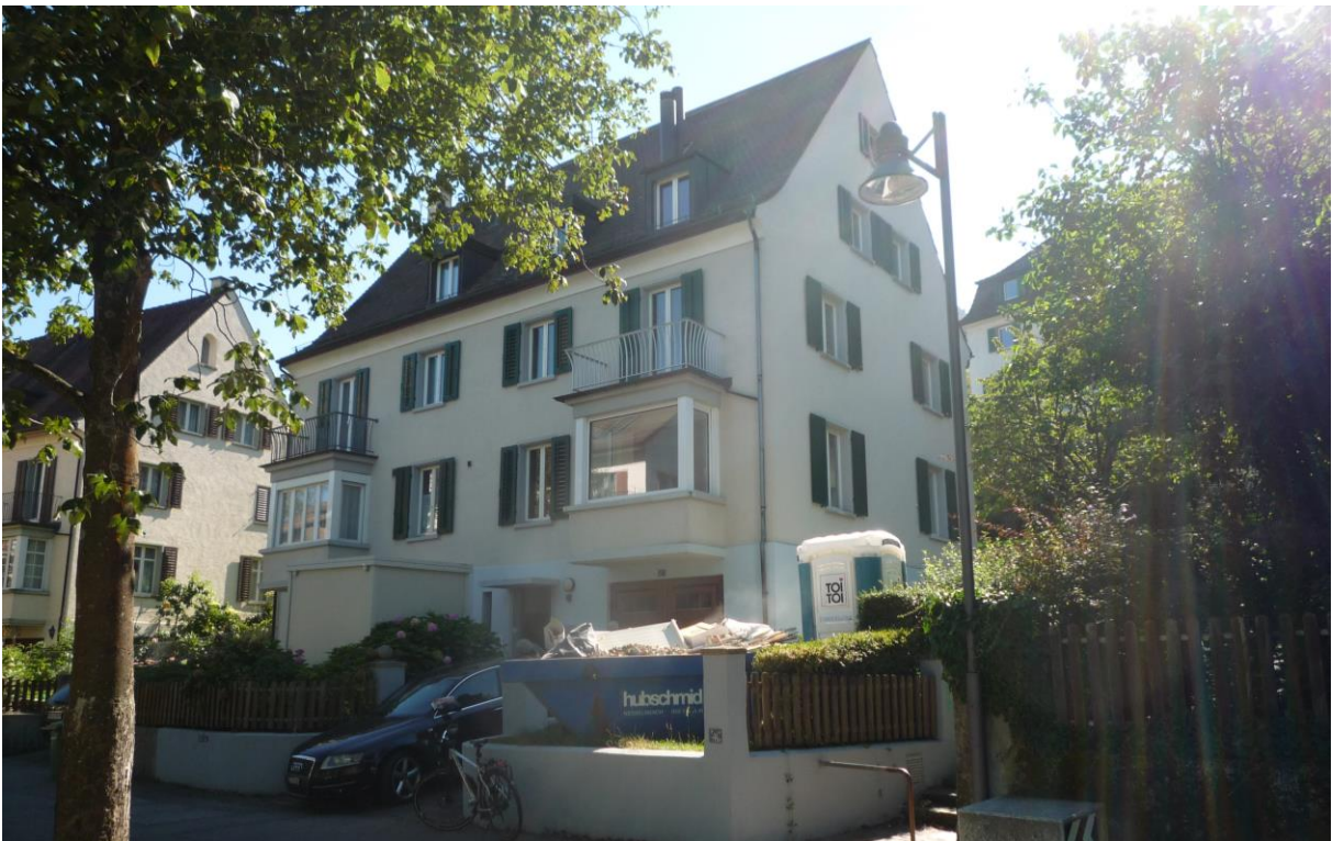
Eines der acht Häuser an der Martinsbergstrasse wird umgebaut und energetisch ertüchtigt
