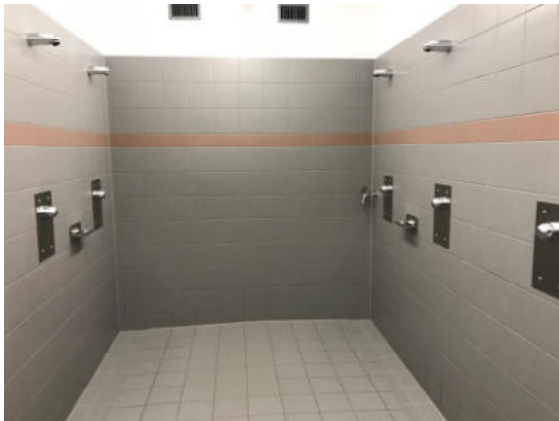
Einzelhalle Rütihof, Duschanlage
