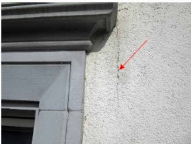
Feine Rissbildung neben Sturz und Verdachung: Es ist anzunehmen, dass die Form des Risses das effektive Ausmass dieser Bauelemente zeigt (Nordfassade 1. OG).
