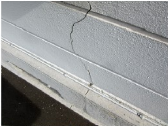
Riss an der Westfassade Sockel
