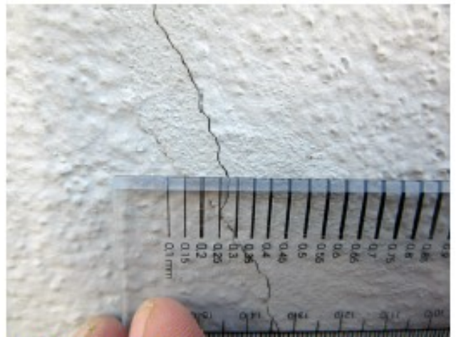
Hier wurde ein Riss bereits zu einem früheren Zeitpunkt mit Mörtel ausgebessert, die Reparaturstelle weist jedoch erneut Rissbildungen auf (Westfassade EG).
