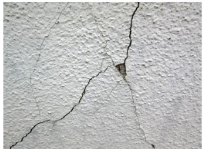
An Positionen, wo Risse sich kreuzen, sind auch bereits erste, kleinflächige Fehlstellen zu beobachten.
