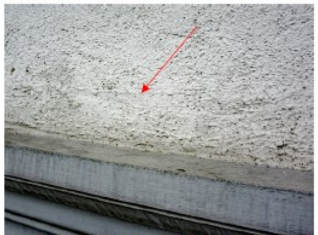
Auch oberhalb der Verdachung sind bei mehreren Fenstereinfassungen solche Risse sichtbar (Nordfassade 1. OG).
