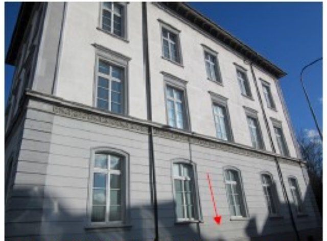
Auch an der Westfassade sind Anstrichausbesserungen erteilich.
